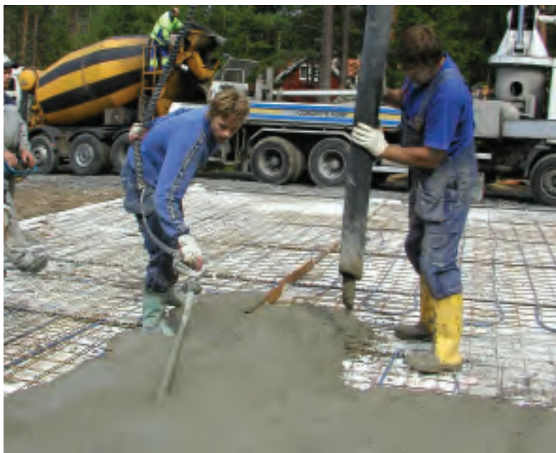
Isoleringsskikt och armering före och under gjutningen. Även golvbrunnar och avloppsledningar är lätta att montera i exakta nivåer på EPS-cellplast.
